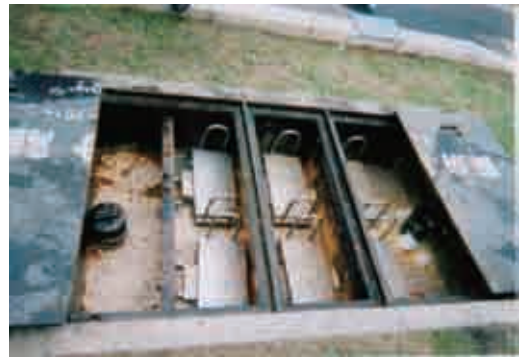
油水分離槽メカセラ導入後
