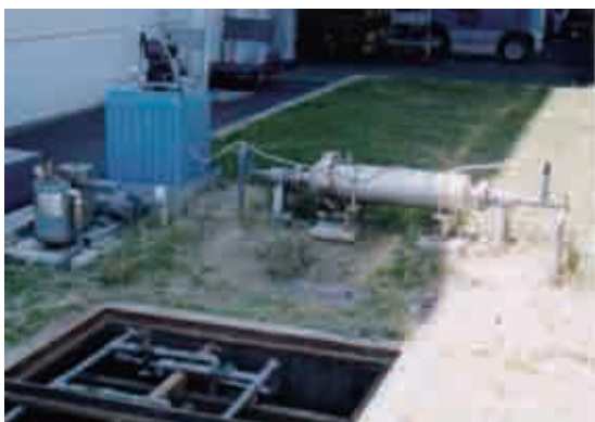
図7：厨房排水用メカセラ装置設置状況
