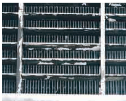
図10：クーリングタワーの状態
