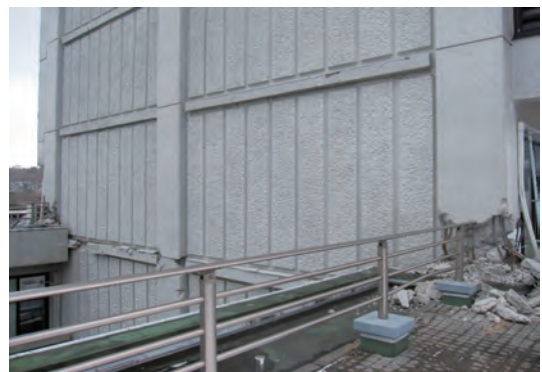
写真2 柱が大破した建物（東日本大震災）
