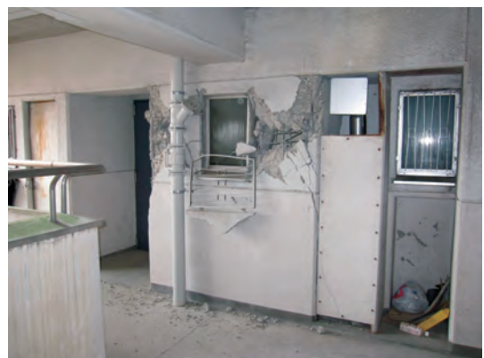
写真4 非構造壁が大破した集合住宅（東日本大震災）
